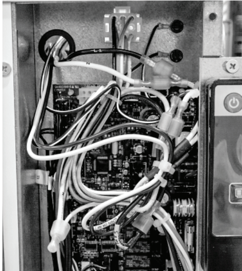
Suministro de energía entrante
